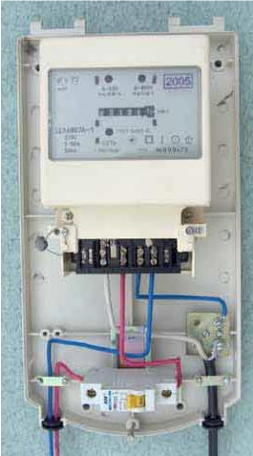
partea din spate a blocului de măsură și protecție.
